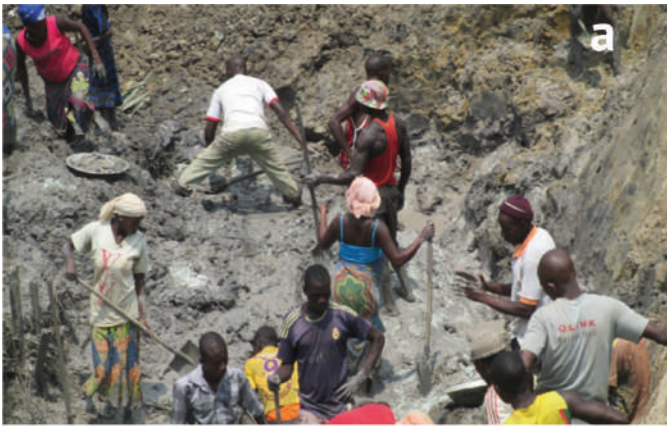
FIGURE 8.2 | (A) EXPLOITATION MINIÈRE STRICTEMENT ARTISANALE AVEC DES OUTILS RUDIMENTAIRES. (B) EXPLOITATION MINIÈRE ARTISANALE SEMI-MÉCANISÉE AVEC DES MACHINES (PELLETEUSES) À BEKE, RÉGION DE L'EST, CAMEROUN (PAUL KEMENG, 2014).
